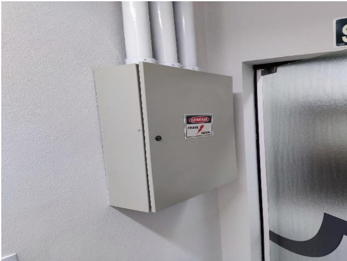
Figura 1 - Foto do quadro geral de distribuição escolhido para alimentação do painel de controle, o qual será instalado ao lado.
